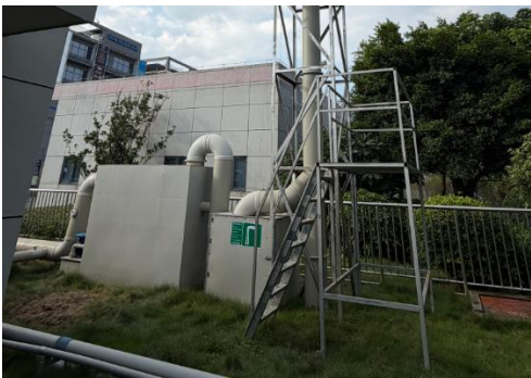
排气筒 FQ-03 远景
