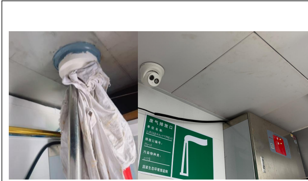
排气筒 FQ-01 远景
