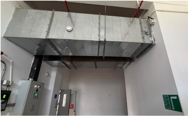
排气筒 FQ-02 远景
