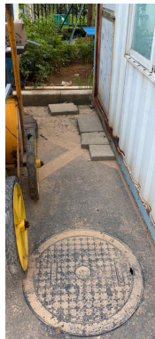
污水排放口远景
